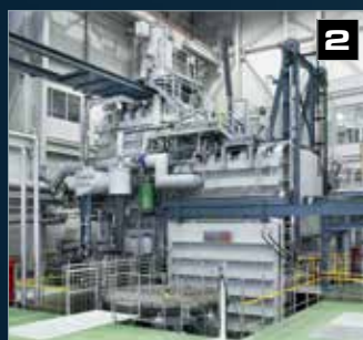
2 VIM炉 (真空誘導溶解) 3ton
