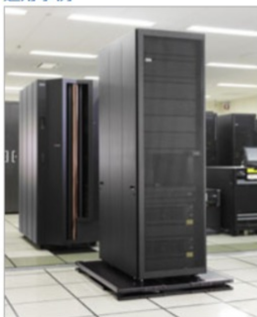
サーバーラック
